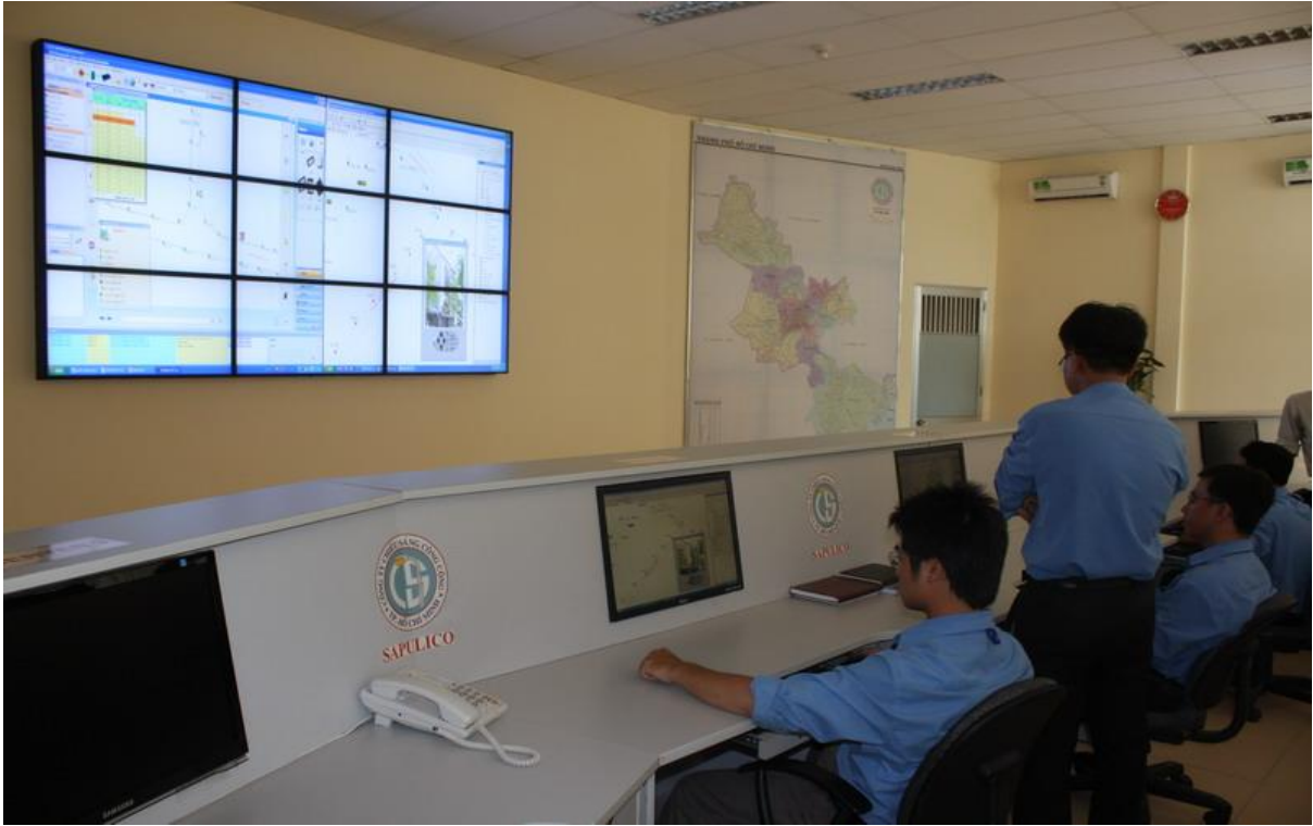
Hình 3.27. Trung tâm điều khiển chiếu sáng công cộng Thành phố Hồ Chí Minh
