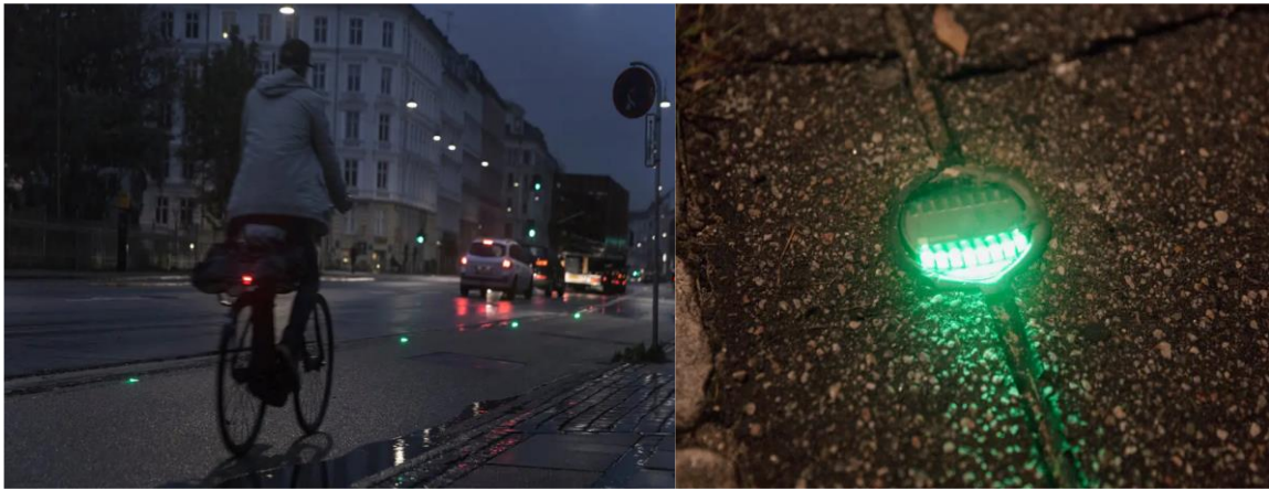
Hình 3.16. Hệ thống chiếu sáng báo hiệu giao thông lắp đặt âm đường ở thủ đô Copenhagen, Đan Mạch
