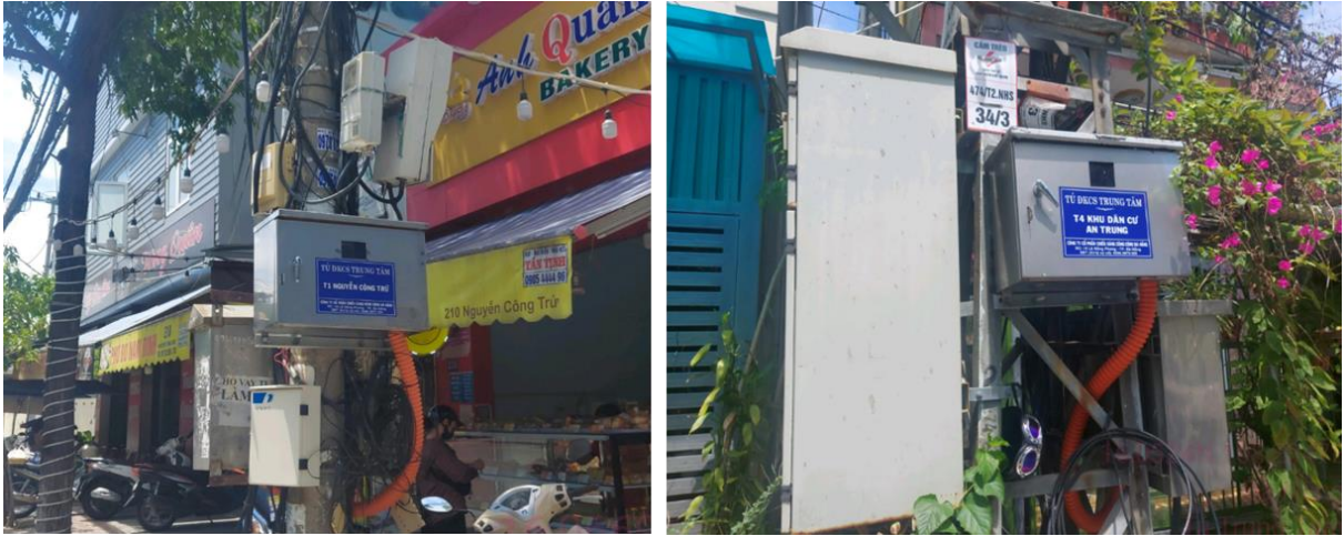
Hình 2.15. Tủ điều khiển chiếu sáng thông minh trên địa bàn quận Ngũ Hành Sơn
