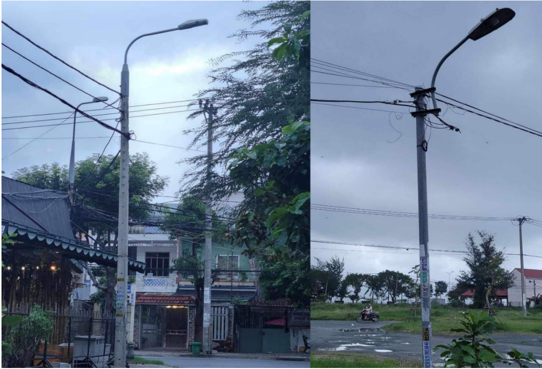
Hình 2.19. Hệ thống chiếu sáng đi nổi trên trụ bê-tông ly tâm của điện lực
