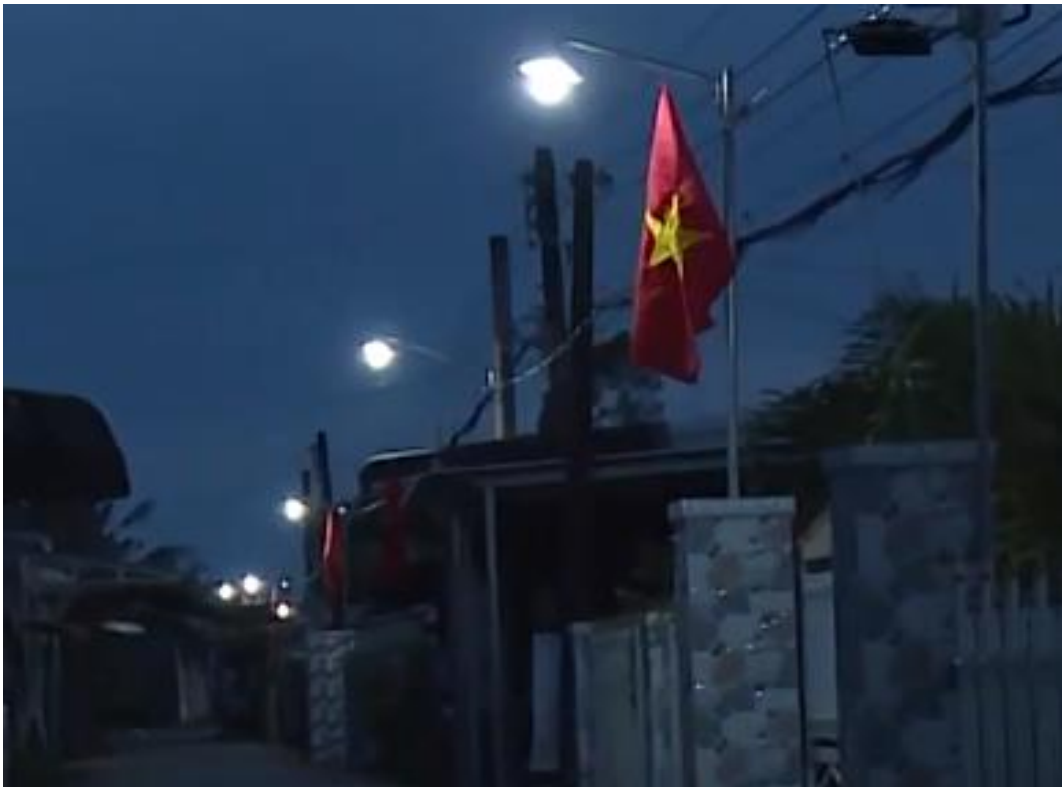
Hình 2.18. Hệ thống chiếu sáng thô sơ lắp đặt trong các đường nội bộ
