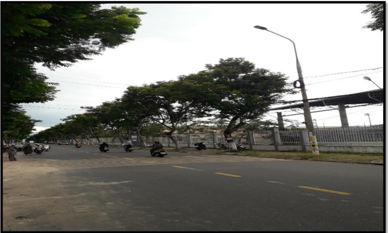
Hình 2.9. Hệ thống chiếu sáng đi nổi trên trụ bê-tông ly tâm của điện lực
