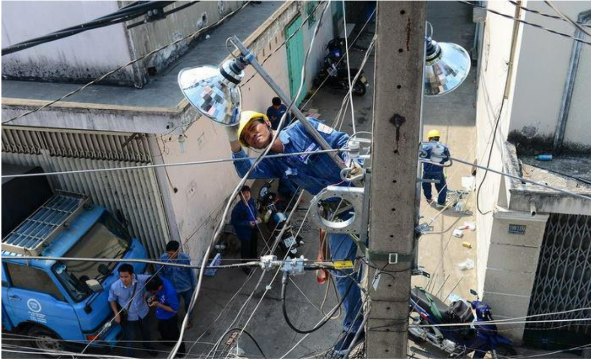
Hình 2.6. Đèn đường gắn trên trụ điện lực trong các hẻm nhỏ ở Tp. Hồ Chí Minh
